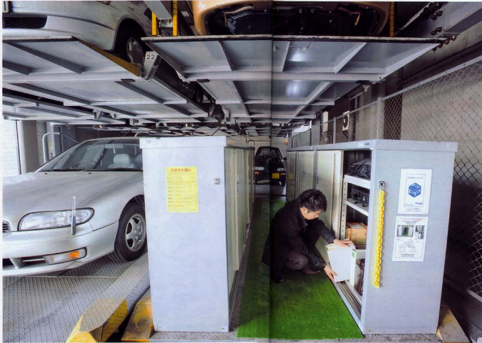
大阪市内のマンションに導入された「P-Cube」。将来、取り外すかどうかによって、リースか購入かを選ぶ
